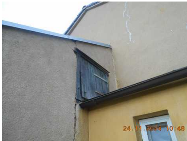
vedlejší stavba za RD, statické poruchy, trhliny
