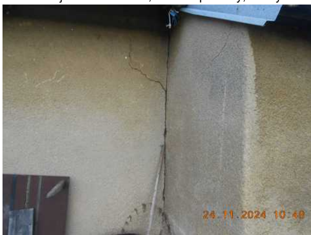
vedlejší stavba za RD, statické poruchy, trhliny
