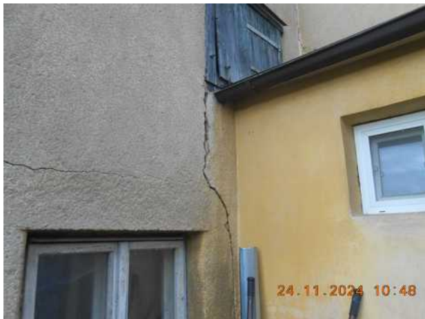
vedlejší stavba za RD, statické poruchy, trhliny
